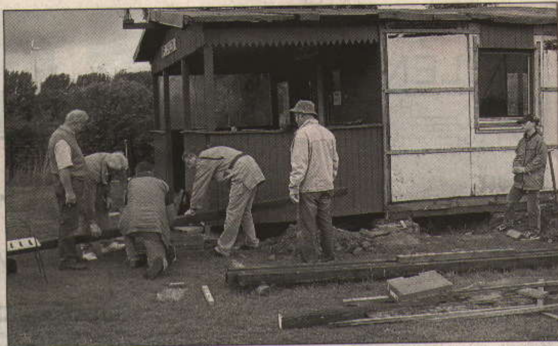
Faul war nur das Fundament: Mit einem zweitägigen Arbeitseinsatz sanierten die Modellflieger den Unterbau ihres Vereinsheims.
